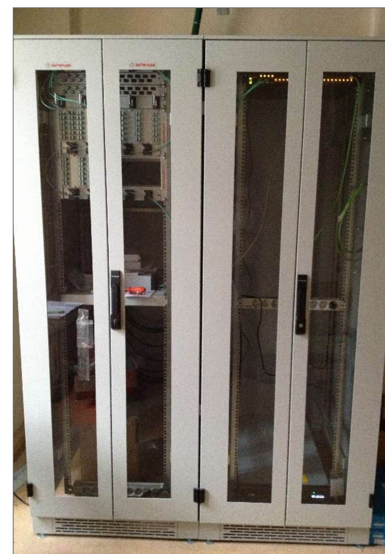
Fernmeldeverteiler 2.OG Raum 218
