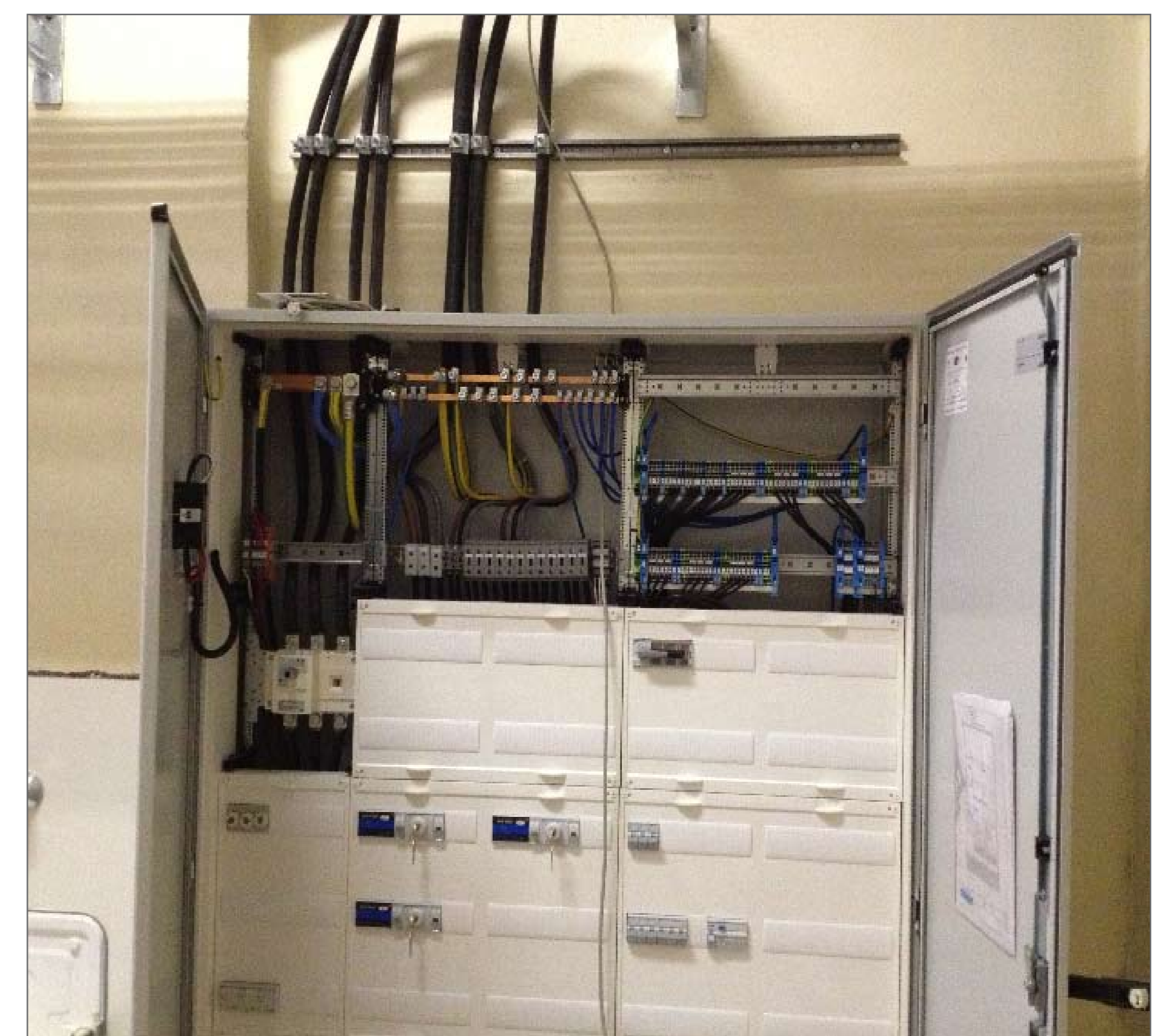
Hauptverteilung 2.OG – Raum 218
